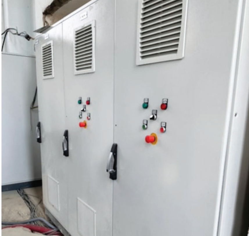
Електро ормари за погон пумпних агрегата
